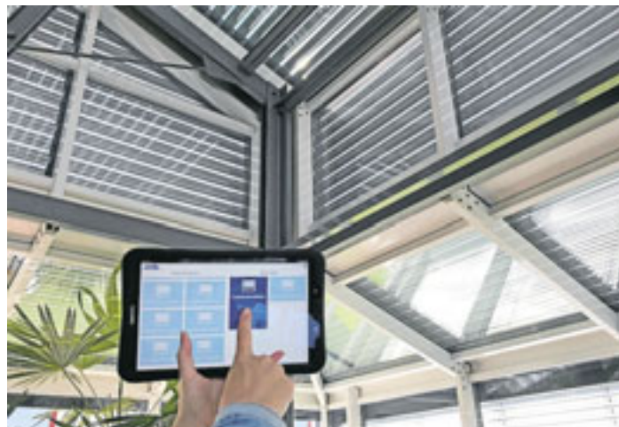
Moderne Rollläden mit automatischem Antrieb kann man über Smartphone oder Tablet steuern, sie halten die Innenräume im Sommer angenehm kühl. Foto: djd/Schanz Rollladensysteme
